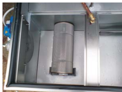
Großer Edelstahlfilter auf der Pumpenansaugseite
